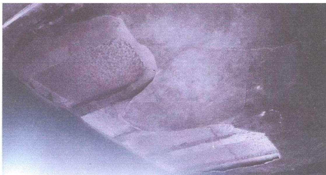
Foto 12 – Laje com deslocamento do acabamento
