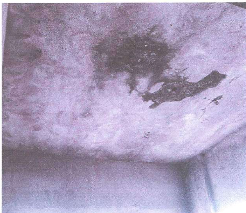
Foto 11 – Laje com sinais de infiltração
