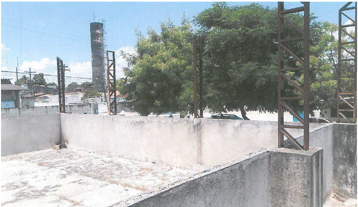
Imagem 05: Estrutura metálica será recuperada em razão da oxidação decorrente da ação temporal. A mureta será rebaixada para a altura de 1,10m.
