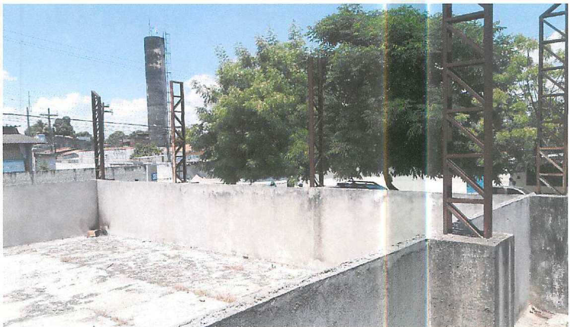
Imagem 05: Estrutura metálica será recuperada em razão da oxidação decorrente da ação temporal. A mureta será rebaixada para a altura de 1,10m.
